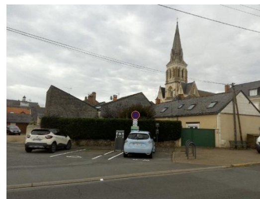
Borne de recharge pour véhicules électriques, Tiercé
